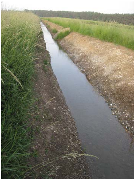
Luixenhartgraben, L1, unsachgemäße Gewässerräumung auf ganzer Grabenlänge, 29.05.08
