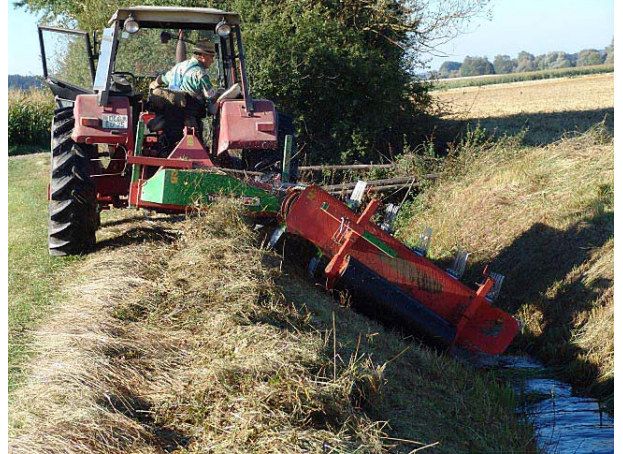
Mit einem Bandrechen als seitlichen Ausleger ist eine rationelle Streuentfernung auch an steilen Böschungen möglich
